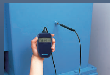
空調機器の能力試験・保守点検
