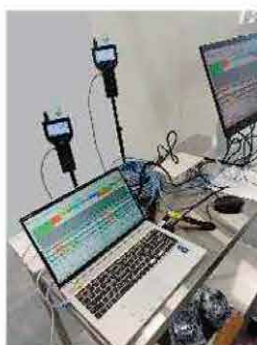
クリーンルーム監視システム立上げ
